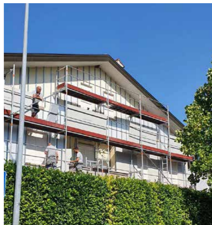
INTERVENTO DI ISOLAMENTO IN PARETE A ALBIGNASEGO (PADOVA). SOTTO, INTERVENTO IN UNA VILLA
